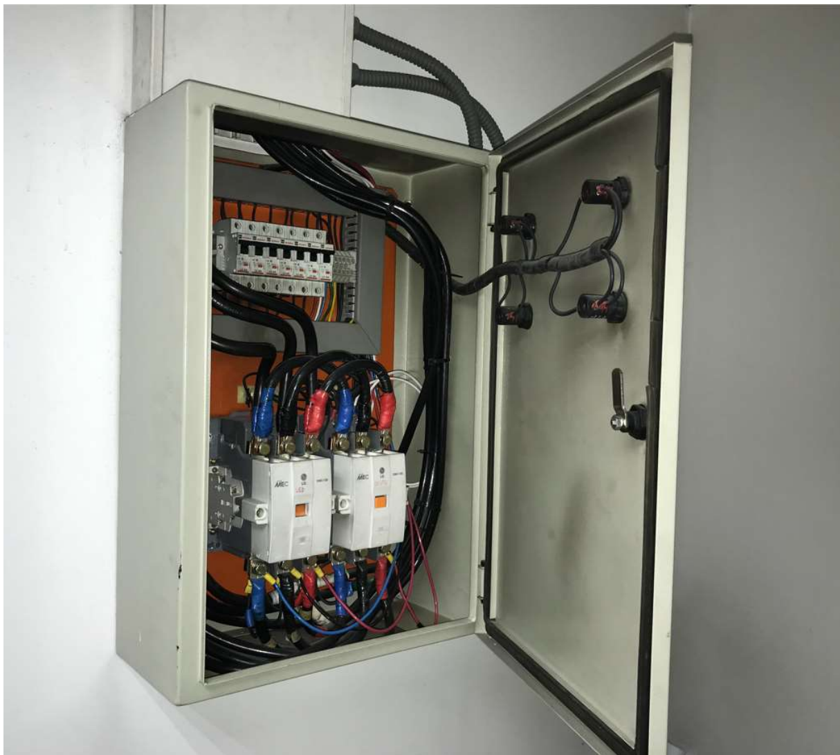
(Imagen 3: TTA Trifásico 125 amperes ubicado en el piso 12, en el exterior del Data Center)
