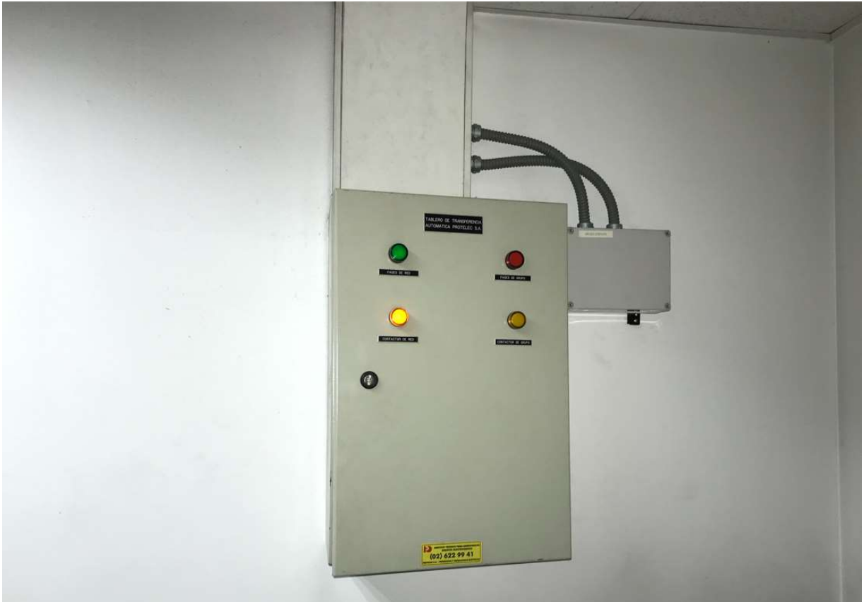
(Imagen 2: TTA Trifásico 125 amperes ubicado en el piso 12, en el exterior del Data Center)
