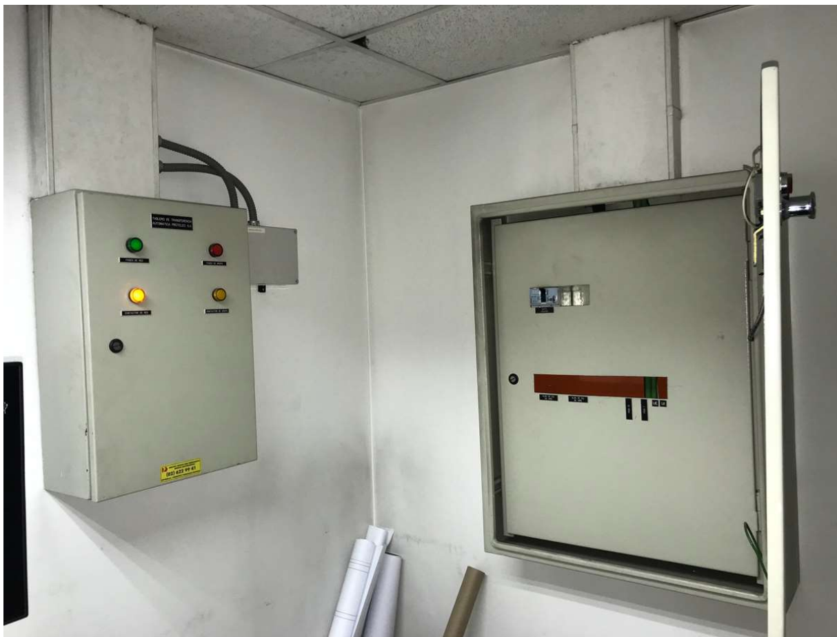
(Imagen 4: TTA Trifásico 125 amperes, además tablero de paso hacia el Data Center 100 % disponible para operación de instalación, ambos ubicados en el piso 12, en el exterior del Data Center)
