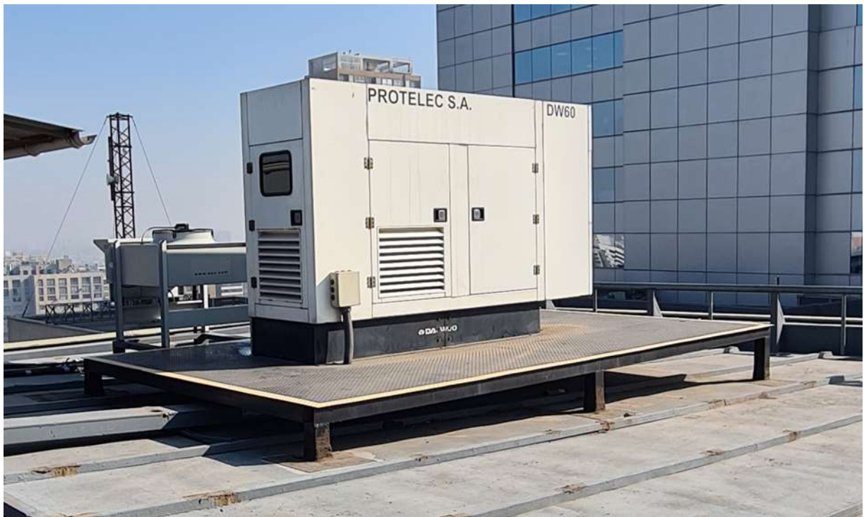
(Imagen 1: Grupo Electrógeno Trifásico 65 kVA ubicado en la azotea piso 15)
